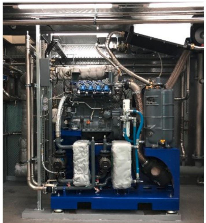
Herzstück des DHKW - Kompressor zur Wärme und Druckluftherzeugung
