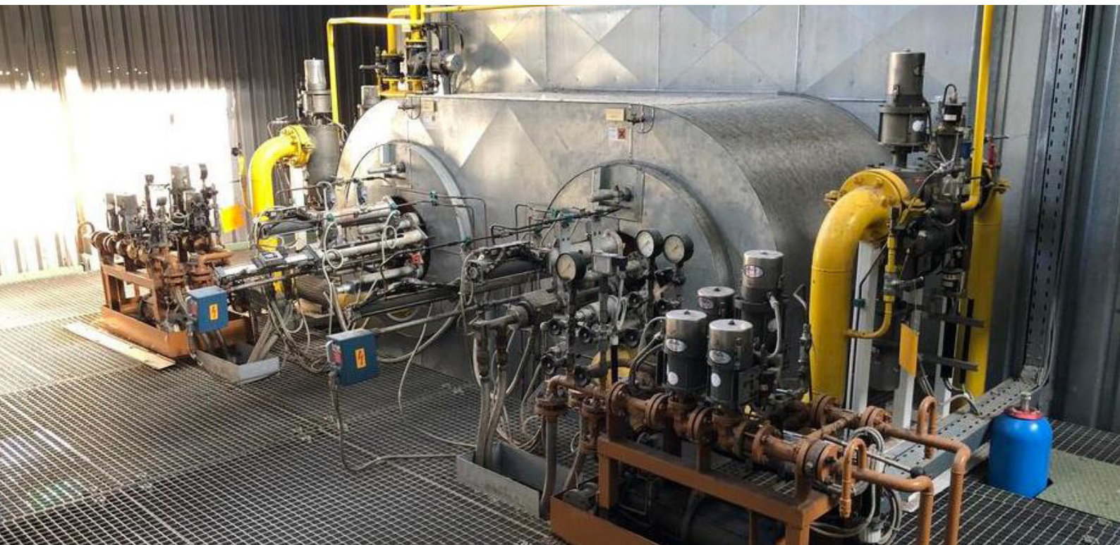
Abb. 28: Heizkessel des Heizkraftwerkes am Standort Wörth
