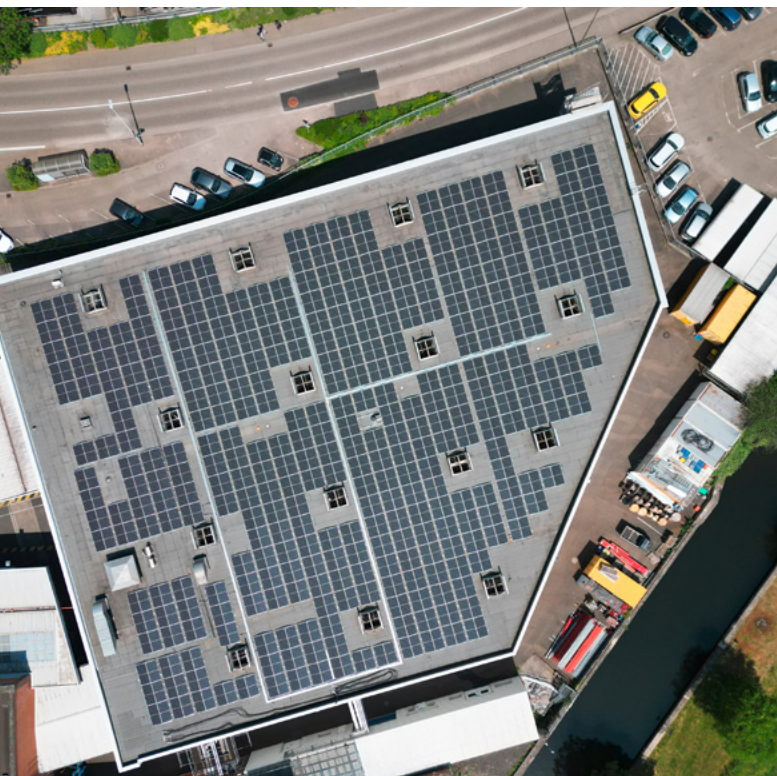
Photovoltaik-Anlagen auf dem Bau 23 und Parkhaus am Standort Gaggenau
